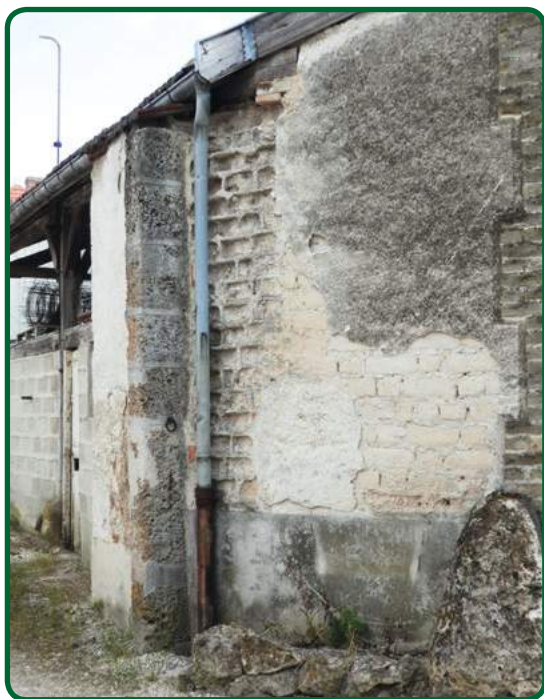
Bâtiment en carreaux de terre crue très dégradé, Bouzy.
